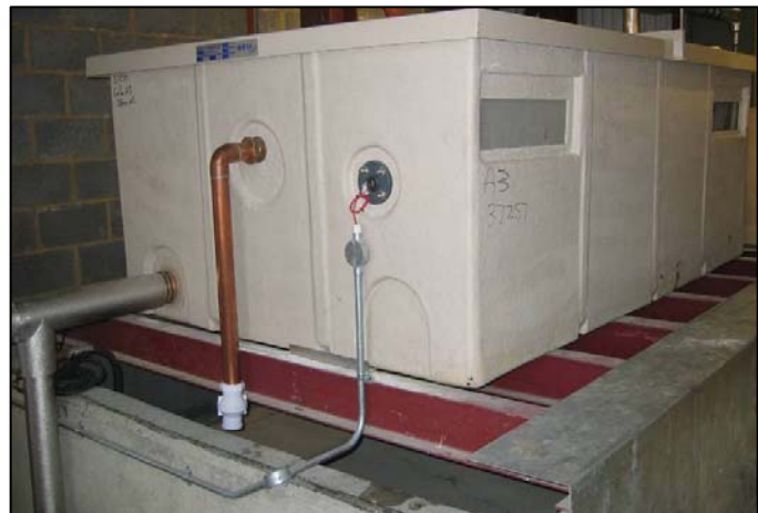
Fig. 7 : Cuve d'alimentation sous le toit
